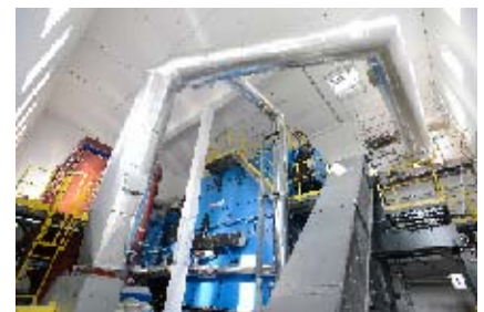
AFUL Chaufferie Biomasse - REZÉ (44) © Mezerette-Ville de Rezé
