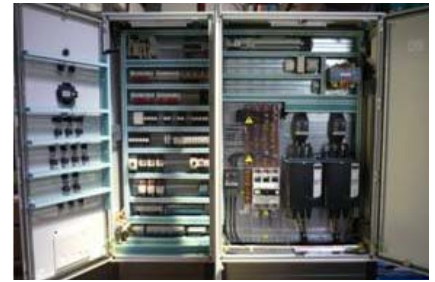
Armoire puissance automatisme
